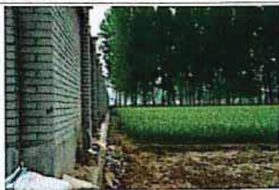
变电站西墙外
