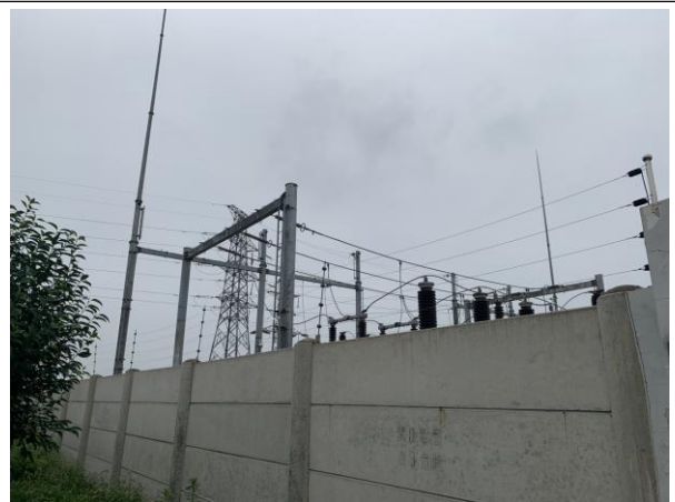
110kV 海露变出线间隔现状照片
