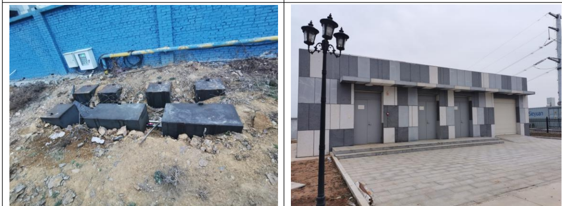
一体化污水处理装置
