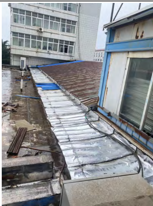
DSA 机房上方（屋顶）
