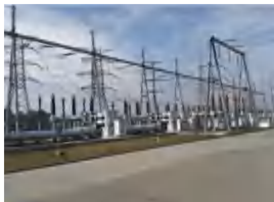
摩云变 220kV 配电区
