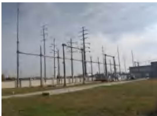
摩云变 110kV 配电区
