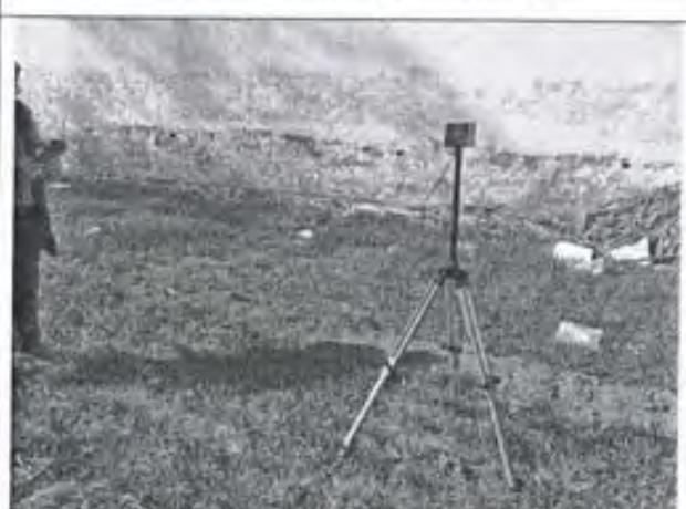
扩建间隔变电站现状监测照片
