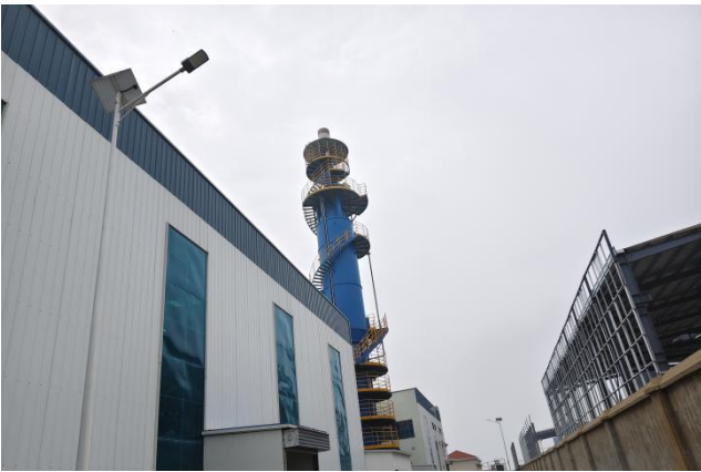
现有工程脱硫塔
