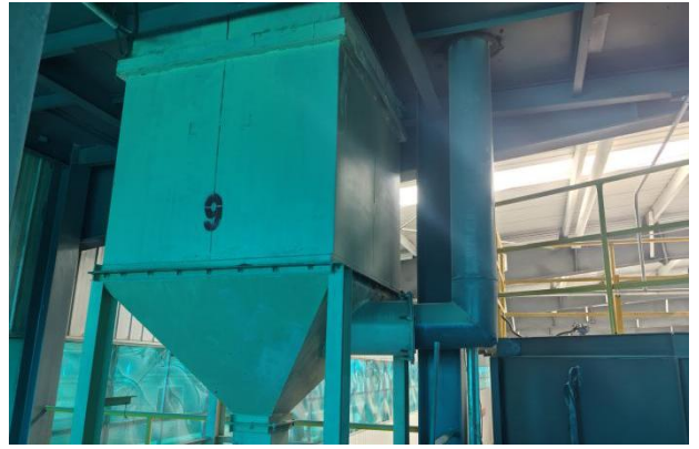
现有工程 9#袋式除尘器
