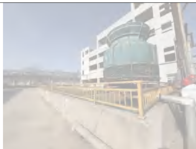
开放式循环冷却塔
