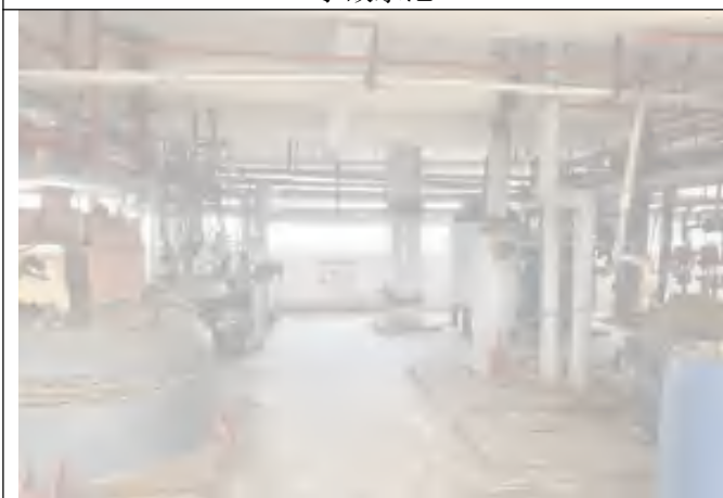
现有工程厂房内
