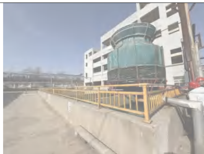
开放式循环冷却塔
