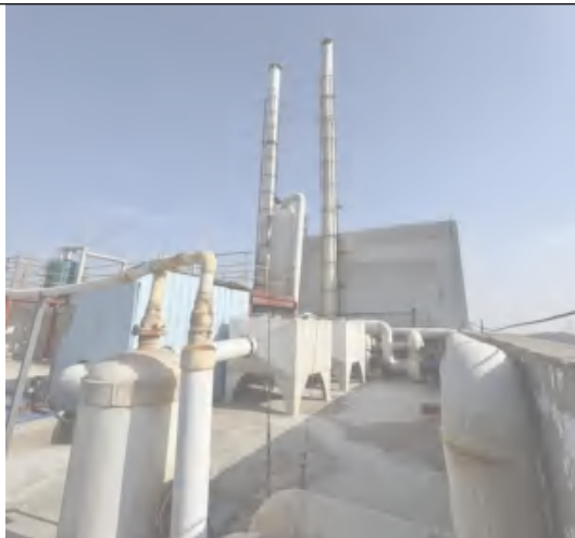
废气治理设施
