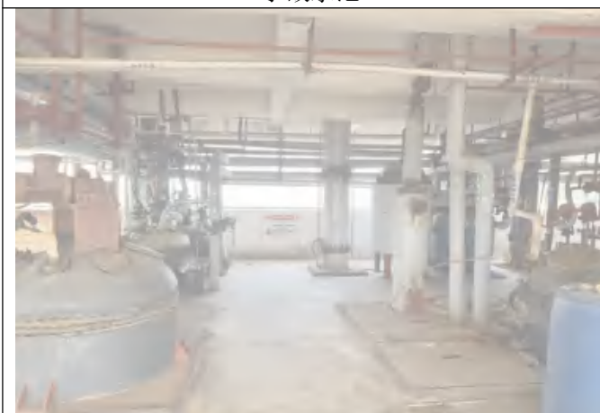
现有工程厂房内
