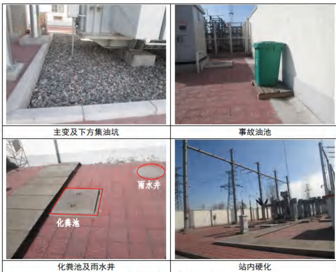
图 3-4 秦赵变电站内环保设施现状照片
